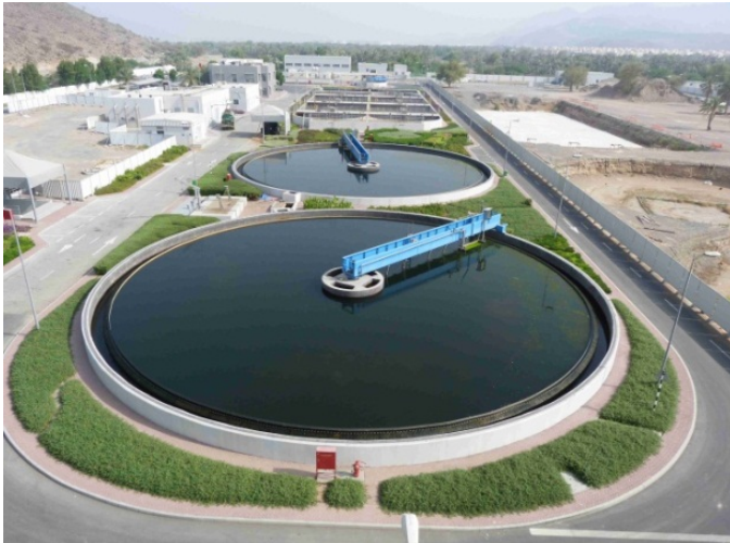
Kläranlage in den Vereinigte Arabische Emirate (Foto: EW)
