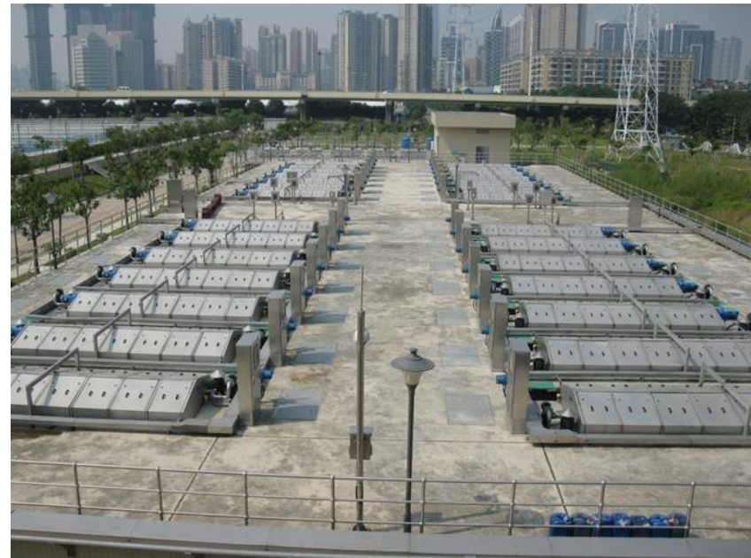
Mikrosiebanlage in Lie De, China (Foto: Huber SE)
