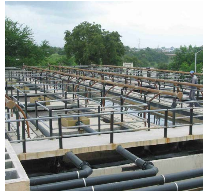
Anaerobanlage in Indien (Foto: LU Hannover)
