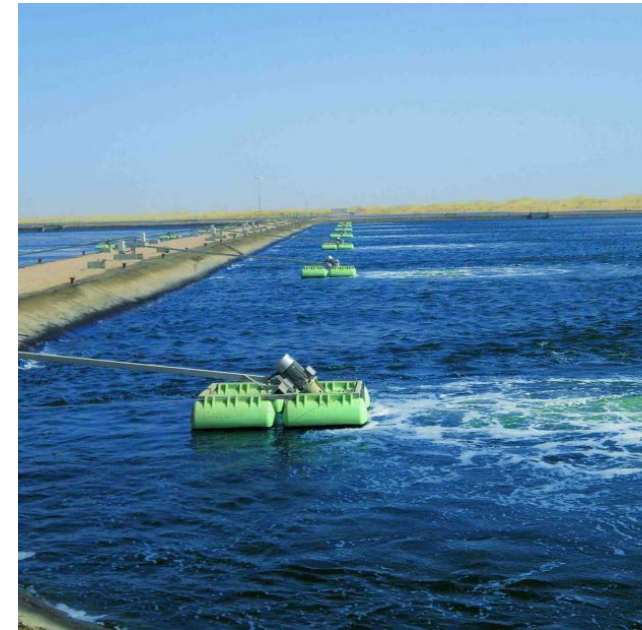
Abwasserteichanlage in Algerien, 275.000 EW (Foto: FUCHS)
