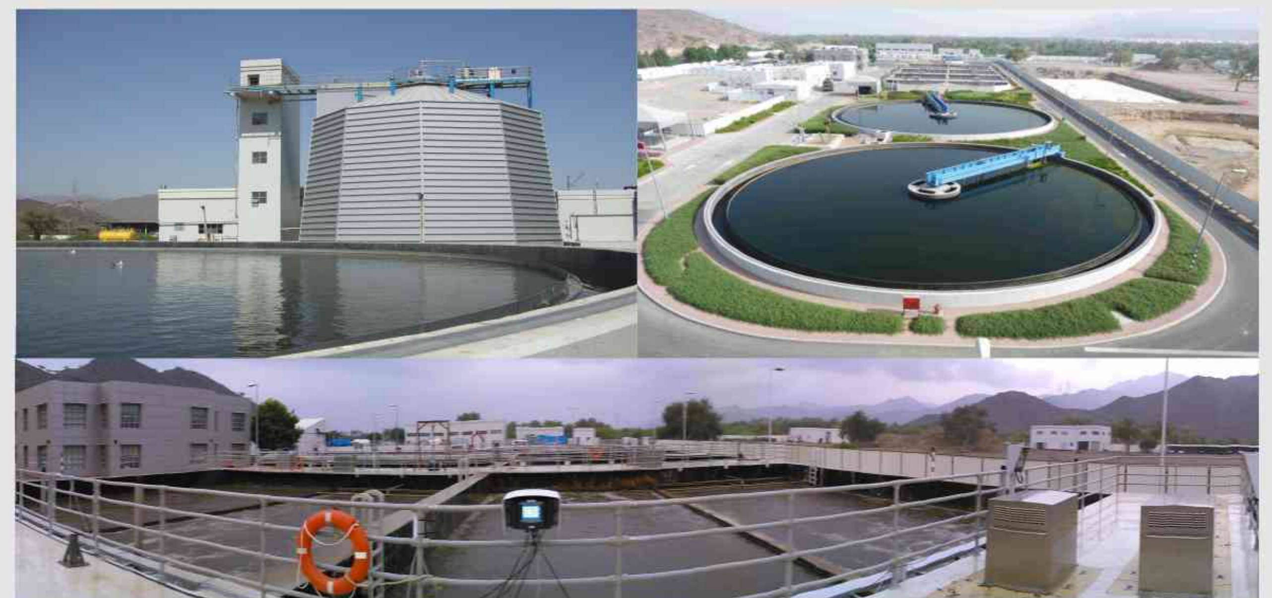
Bild 3: Nachklärung und Faulturn der Kläranlage Fujairah, VAE (Fotos: EW) Belebungsbecken mit Online Controller der Fa. HACH (Foto: RUB)
